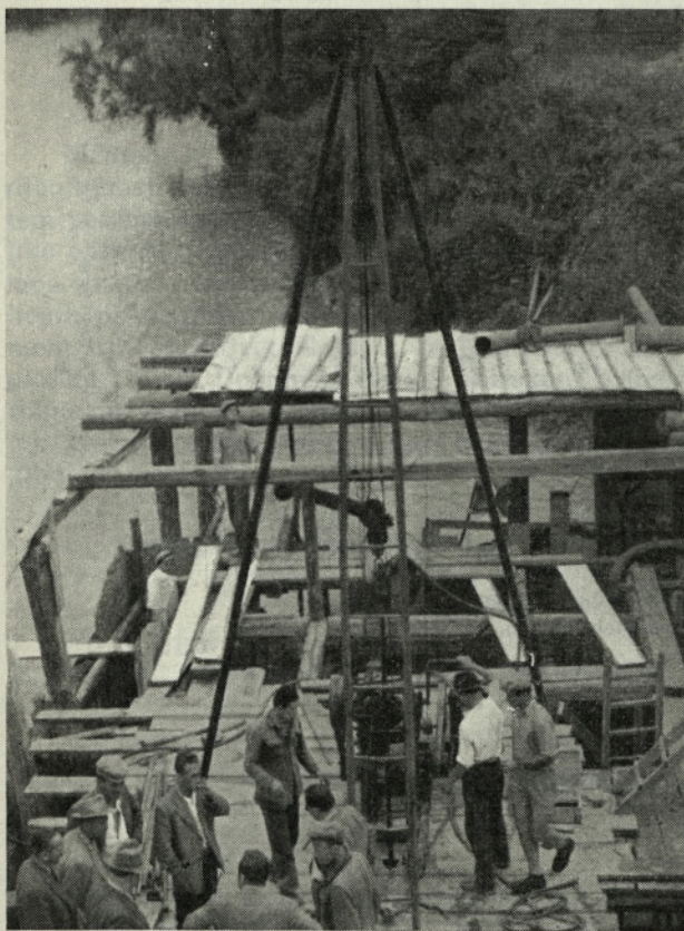
Sl. 1. Dobre geološke in sondažne preiskave so osnovni pogoj za pravilno temeljenje važnejših cestnih objektov. — Slika prikazuje vrtanje za most čez Krko na avtomobilski cesti
