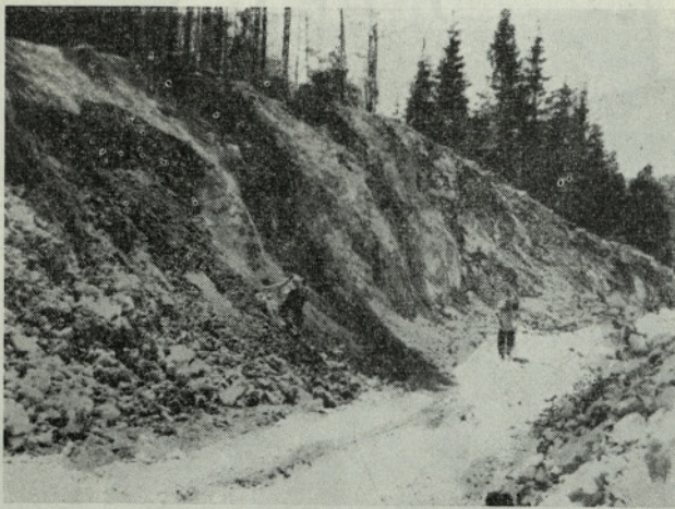
Sl. 6. Globinsko miniranje in zraven še tektonsko porušene cone so sovražniki stabilnih brežin, zlasti če je skala še zakrasela in preprežena z žepi ilovice. — Na sliki je tak primer za časa gradnje avtomobilske ceste na Medvedjeku pri Radohovi vasi
