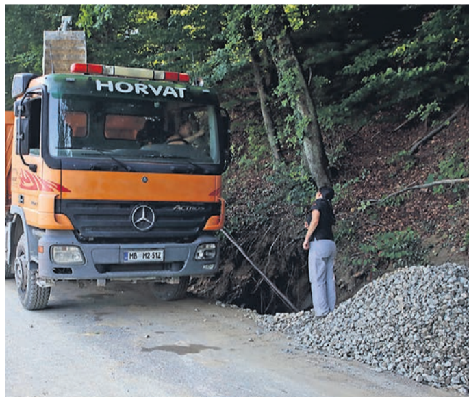
Neurja s silovitimi nalivi bankine ob cestah nemalokrat popolnoma uničijo. Čeprav občine vsako leto poskrbijo za nekaj kilometrov novega asfalta, so vlaganja v cestno infrastrukturo med haloškimi griči zgodba brez konca. En odsek se uredi, na drugem mestu medtem že nastane nova luknja. Ali pa dve, tri ...
