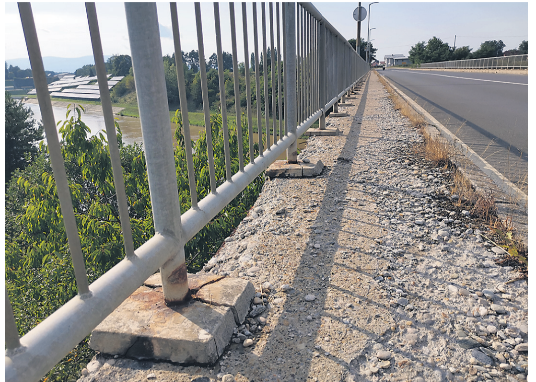
S fotografije je jasno razvidno, da je na nekaterih delih pločnika vrhnja plast asfalta ne le uničena, temveč je splohni več. Tudi rob mostu se je že vidno skrušil.
