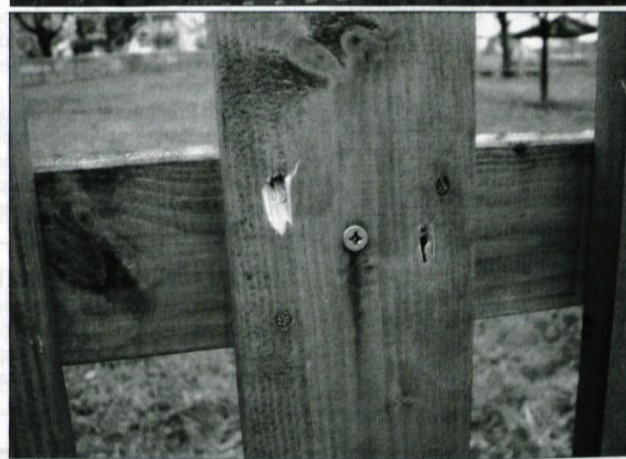
Zgornji dve desni fotografiji: Uničena ograja
