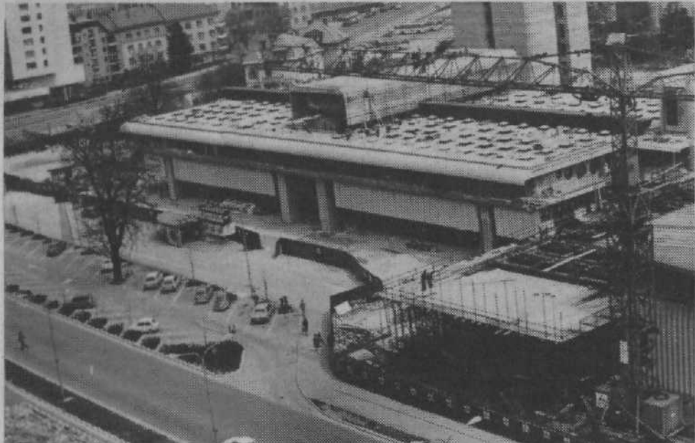
Ob devetem maju je Ljubljana dobila velik prodajni center Slovenijales poleg Gospodarskega razstavišča, ki je eden največjih in najbolj sodobnih v državi. Na 19.000 kvadratnih metrih bruto površin je razstavni prostor kar slaba polovica. V tem prodajno-razstavni centru bo kupec lahko na enem mestu videl in dobil vse, kar potrebuje za zgradnjo in opremo doma.
