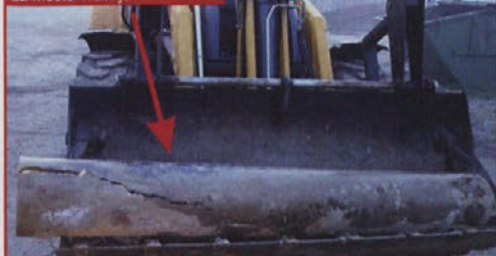
Tako izgleda počena azbestna cevi, ki napaja glavni vodovod za mesto Trebnje
