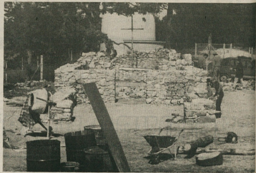
Tako je bilo videti gradbišče na vrhu Gorjancev, ko se je pozidave in ureditve ostankov zidov lotil Tone Hočevar iz Šmalče vasi pri Šentjerneju.
