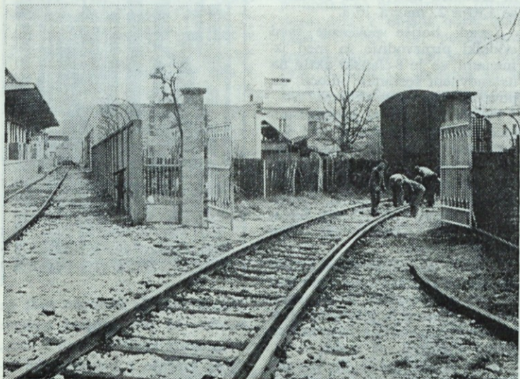
Železniški pragovi industrijskega tira so obrabljeni... Industrijski tir bo v času 1978/79 temeljito obnovljen. Dolžina industrijskega tira št. 1 in tira št. 2 je 431 m.
