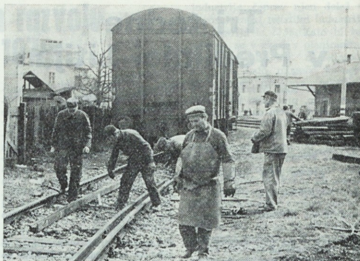
Ob iztirjenju vagona je bila poškodovana tirnica. Pri popravilu industrijskega tira so pomagali tudi varilci naše delovne organizacije.
