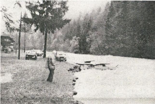
Pretrgana cestna zveza med Stahovico in Kamniško Bistrico. Dela ceste nad Gamsom ni več
