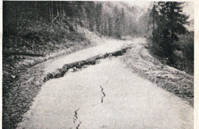
Plaz nad Romšakovo hišo je povzročil vidne poškodbe na cesti
