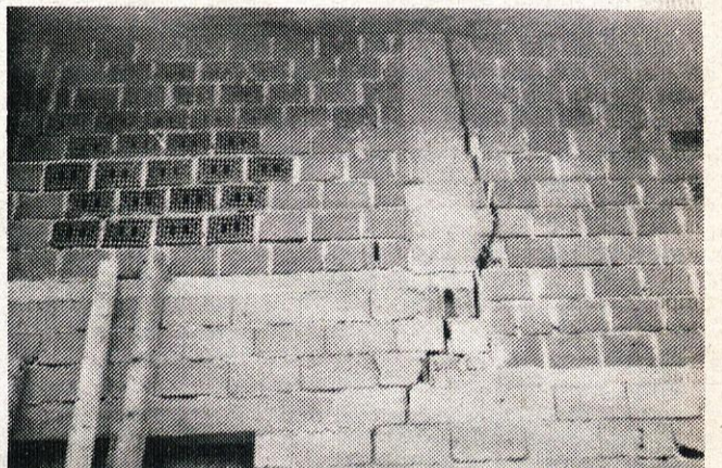
Široka razpoka na hlevu je posledica premikanja tal pod njim
