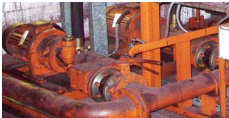
Slika 3 : Sklop hidravličnih črpalk
