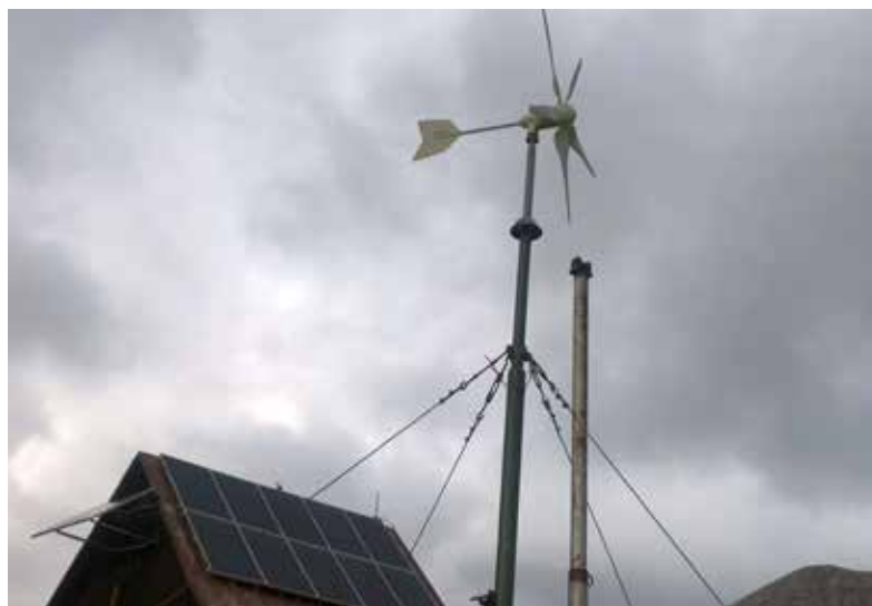
3000 Wp PV-sistem, nameščen na pomožni zgradbi, in 1000 W vetrna turbina StormyWings
