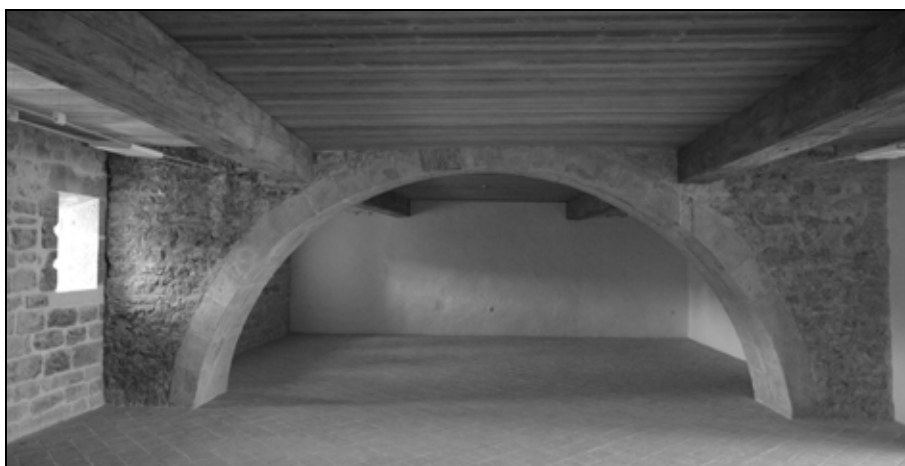
Široki romanski lok v notranjščini nekdanjega prvega nadstropja palacija nosi predelno steno v nekdanjem drugem nadstropju (foto: Igor Sapač, 2011).
