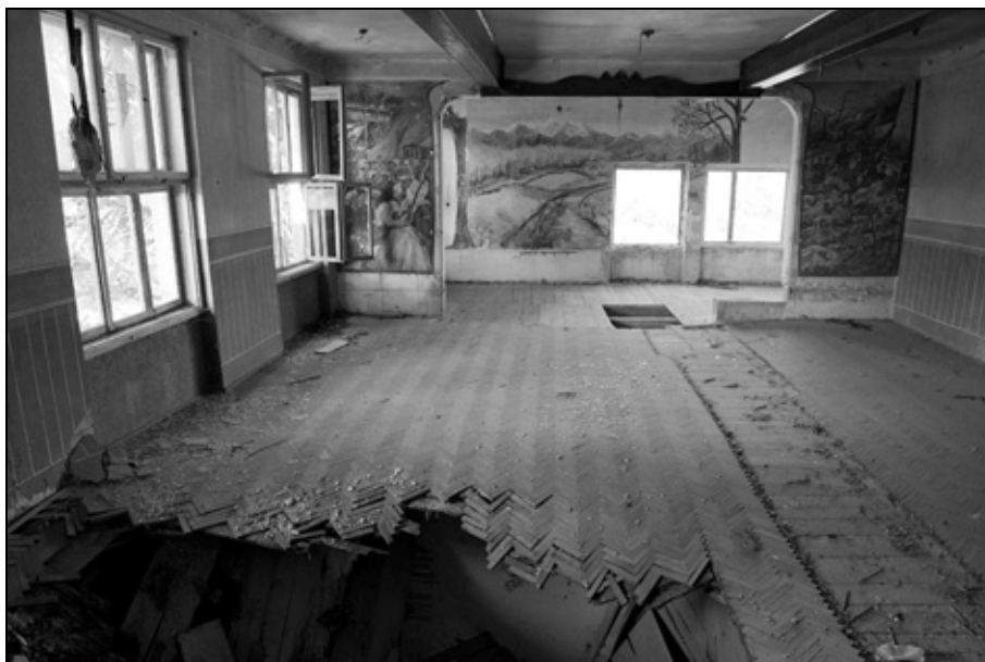
Propadajoča poslikana dvorana v stavbi za osebje kazenske ustanove (fototeka MAO).
