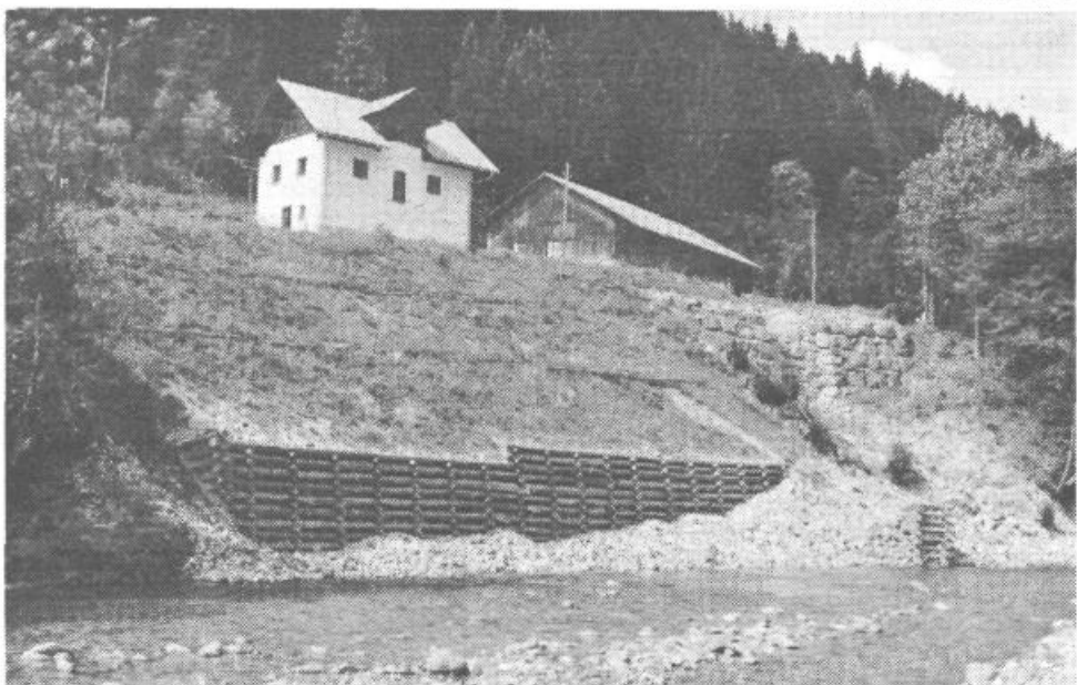
Tudi v hudourništvu uporabljajo v zadnjem času pristope in materiale, ki so bolj prijazni okolju. Tako so n.pr. pri Prušnikovi domačiji nad Savinjo uporabili za varovanje brega pred deročo vodo leseno kašto, za zaščito brežine pred površinskim delovanjem vode zatravitev in vrbov poplet, strugo hudourniškega Pršnikovega grabna pa so utrdili s kamnito pregrado iz avtohtonega kamenja. (Foto: S. J.)
