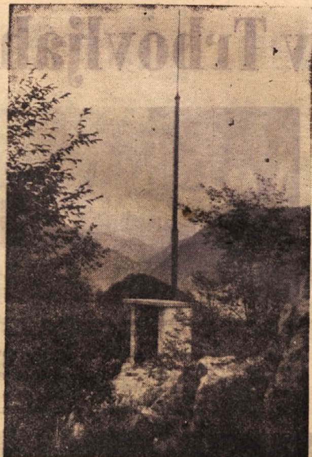
V Zagorju gradijo na »Hrasteljevi skali« TV pretvornik. S prostovoljnimi delom in s pomočjo kolektivov sta bila zgrajena hišica za naprave in stolp. V torek zvečer je na vrhu stolpa že zagorela rdeča lučka. Upajo je, da bo TV pretvornik že kmalu začel z delom
