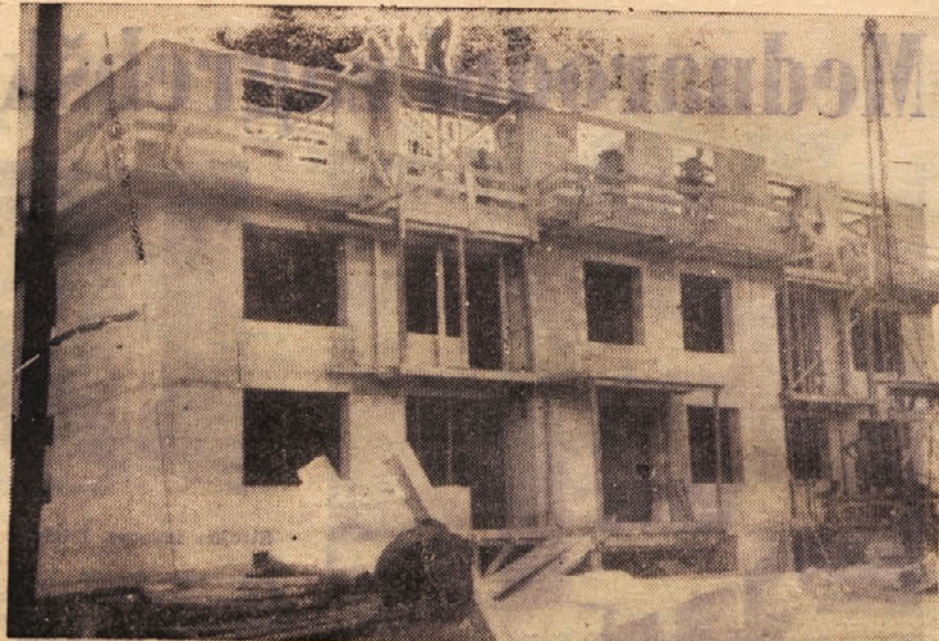
Gradbeno podjetje Zagorje ob Savi gradi v Sevnici za Zavod za stanovanjsko izgradnjo stolpič. Zdaj imajo dograjene tri etaže, do konca meseca bodo pa še dve. Računajo, da bodo do konca leta blok v celoti dogradili, z investitorjem so pa sklenili pogodbo za gradnjo do »ključa« .
