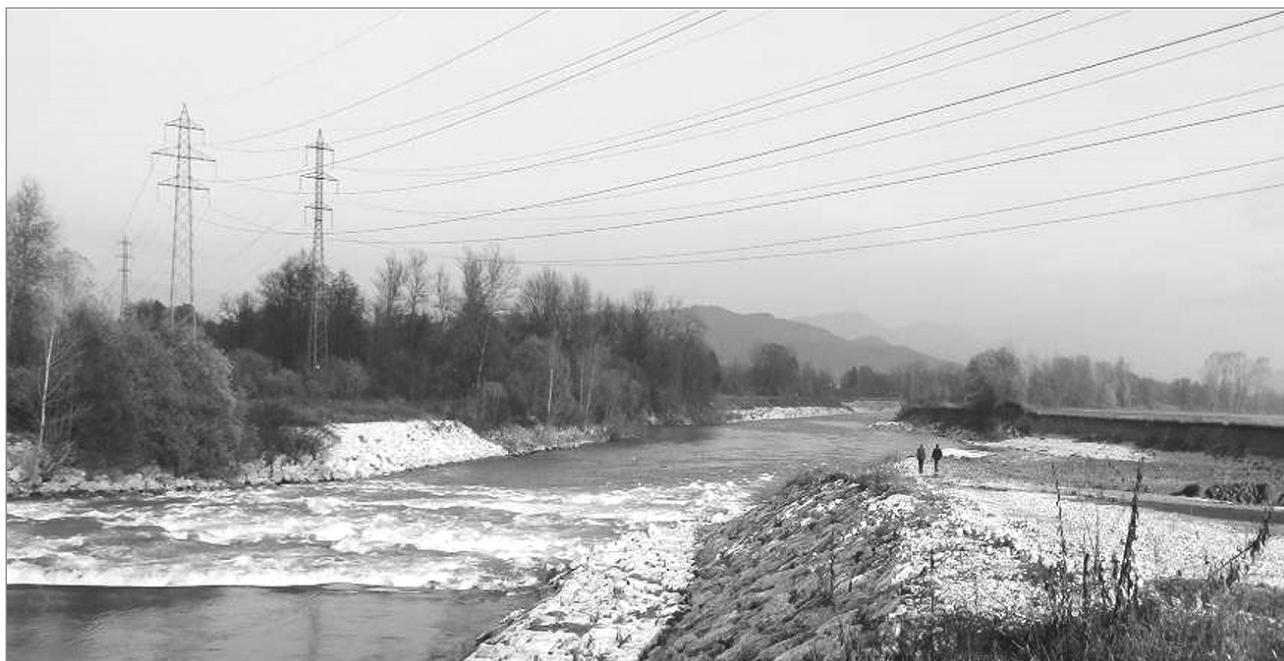
Slika 5: Erodirana brežina Save pod pragom pri Šentjakobu – vzdolžna poškodba desne brežine nakazuje primerno naravno širino struge (vir: avtor).
