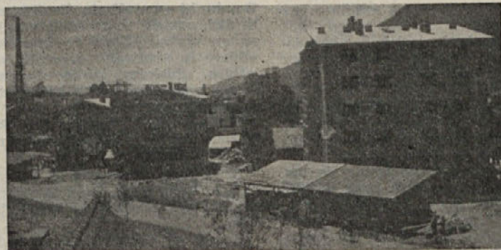
70 NOVIH STANOVANJ. — V trikotniku med Tomšičevo, Cankarjevo in Seškovo ulico lepo napreduje gradnja dveh 20-stanovanjskih stolpičev in bloka cenjenih stanovanj. Od skupnih 70 stanovanj bo 50 vseljivih že septembra. Razen stanovanj grade na tem območju tudi garaže.
