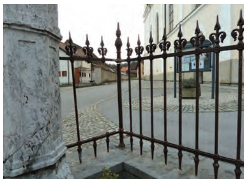
Vrhnika, ž. c. sv. Pavla, stebriči litoželezne ograje so precej poškodovani (foto: Simona Kermavnar)
