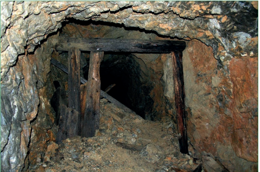
Na nekaterih mestih je predor že zelo dotrajan in nevaren. Foto: Aljaž Hrvatin.
