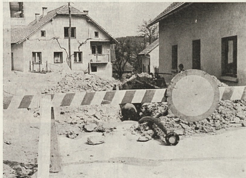
Cerkniško vodovodno omrežje bo obnovljeno še pred začetkom del na glavnem vodovodu
