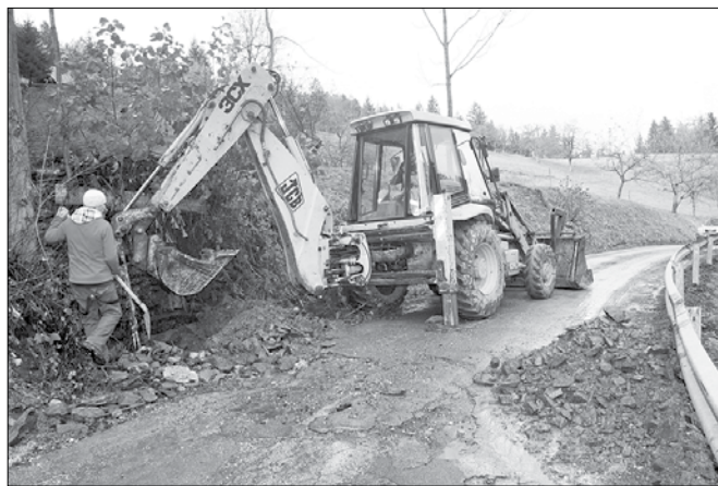
Meteorna voda z okoliških hribov je na večih mestih zasula propuste in čistišče proti Lepi Njivi, ki ga je bilo potrebno z gradbeno mehanizacijo dodobra očistiti, naplavljen material pa odpeljati. (Foto: BK)
