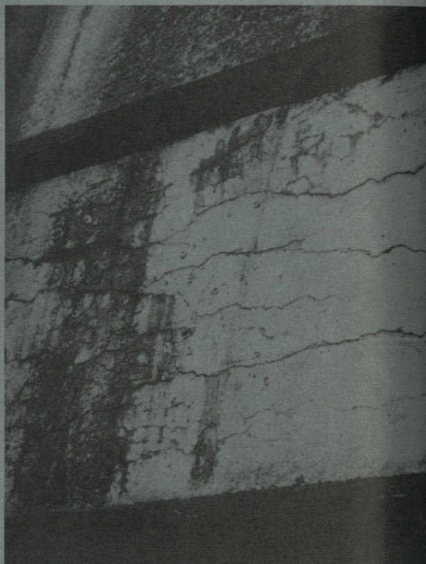
Slika 2: Pogled na beton, poškodovan zaradi alkalno-silikatne reakcije (D. W. Hobbs, Alkali-silica reaction in concrete, London 1988, str. 84)
