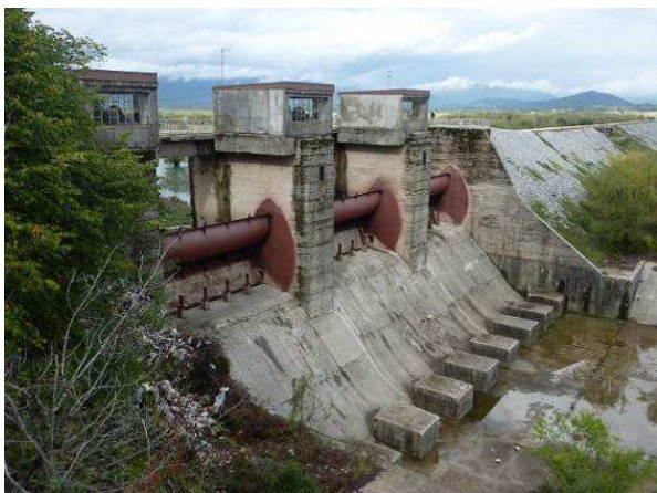
Slika 14: Visokovodni preliv na pregradi Vrtac
