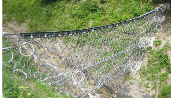
Slika 10: Končni izgled lovilne pregrade
