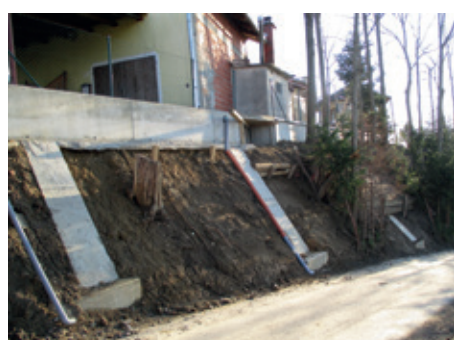
Sanacija plazu v Senesčih
