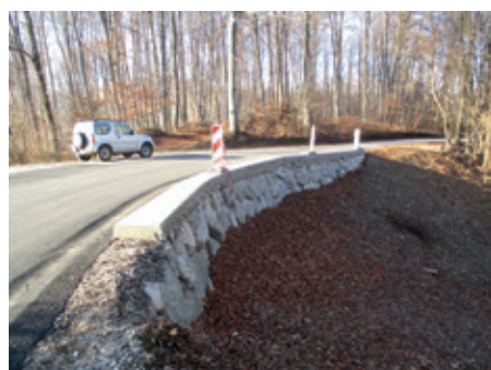
Sanacija plazu v Hermancih
