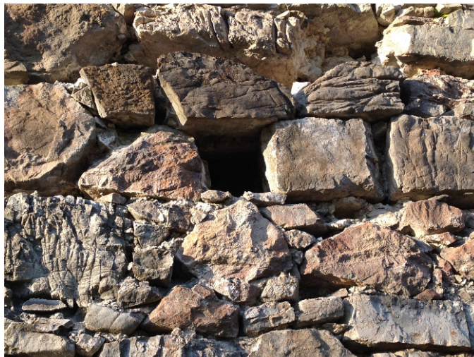
Slika 59: Metodologija, kot jo predlaga disertacija, želi zapolniti vrzel pri sistemskem odločanju o obnovitvenih in vzdrževalnih posegih in pri ravnanju z grajsko dediščino. (Turjak, stari grad, foto: B. Vodopivec)
