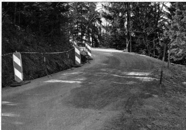
Dosedanjim poškodbam na vozišču se je pridružil še plaz, ki je odnesel cesto z ovinka nad domačijo Polh (foto: Benjamin Kanjir)
