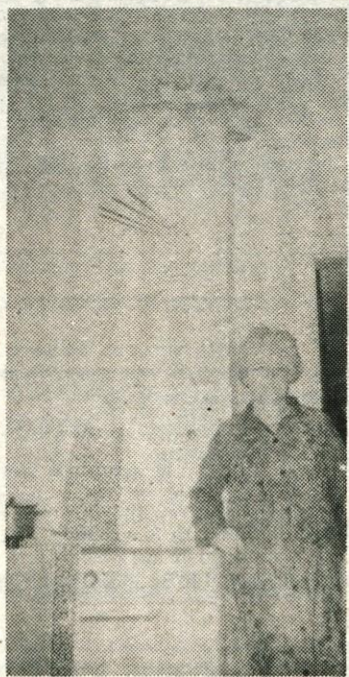
Prav nič dobre volje ni gospodinja, ki ji s stropa teče na štedilnik.
