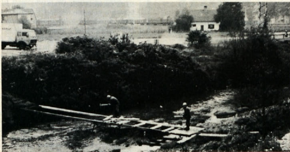
KER JE BIL MOST POŠKODOVAN JE BIL TREBA ZGRADITI ZASILNEGA
