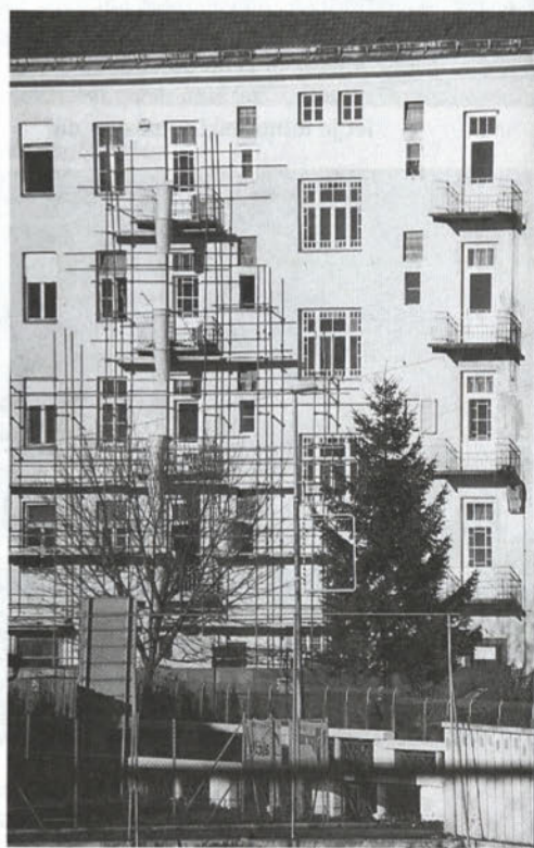
Obnova stavbe v Čučkovi ulici letos spomladi, kjer je dolga leta domoval zdravstveni dom, odslej pa bo v njej 16 stanovanj za socialne upravičence in v pritličju štirje poslovni prostori. Foto: Boris Voglar
