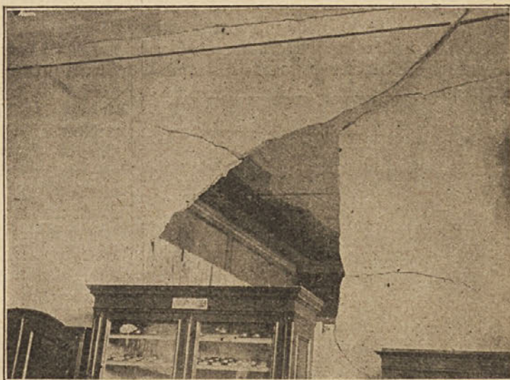
Vremenska katastrofa na Hrvaškem dne 19. septembra: Pregradni zid, ki ga je vlomil veter v vseučiliškem posloppju.
