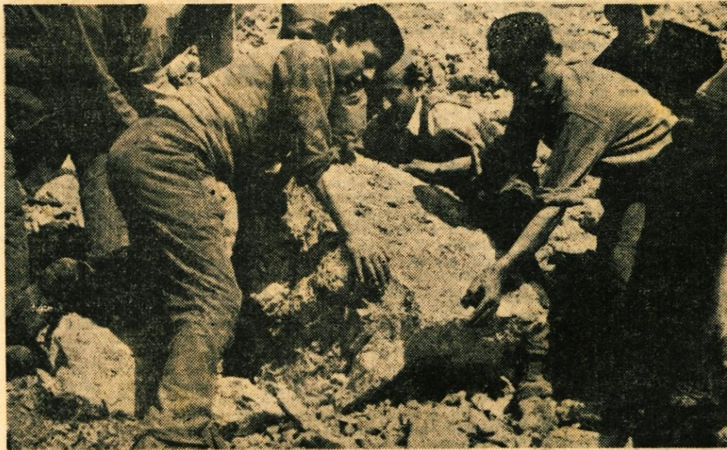
Kjer tudi stroj ne pomaga, tam zgrabijo mlade roke; skala se uda in premakne iz stotisoletnega ležišča — avtomobilska cesta bratstva in enotnosti ne pozna ovir, kot jih ne pozna naš mladi rod, ki ve, da gradi zase in za svobodno, neodvisno domovino pomorno in svetlo bodočnost! — Na sliki: prizorček z dela na odseku avto ceste v neposredni bližini Glavnega štaba na Otočcu.
