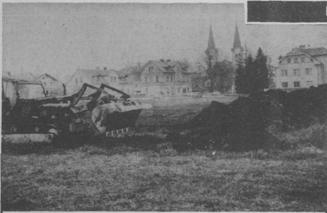
Dela za vodovod do središča Polja so v teku. Kaže, pa, da bo nekaj težav pri odseku skozi naselje, saj trasa novega vodovoda ne teče tako, kot je bilo dogovorjeno. Na sliki: Takole so nedavno tega začeli odstranjevati zgornje plasti zemlje za vodovodne cevi premera 30 cm. (Foto: Dušan Jež)
