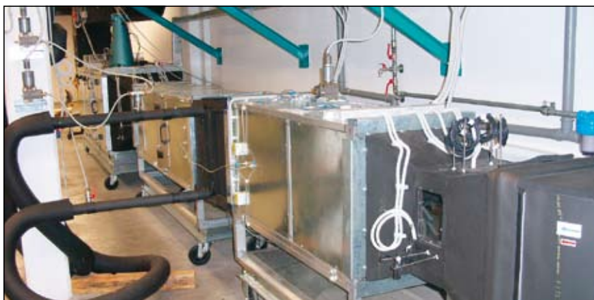
Slika 3a. Pogled na osnovni del merilne proge, smer zraka od desne proti levi (obratno, kot na shemi 3b)
