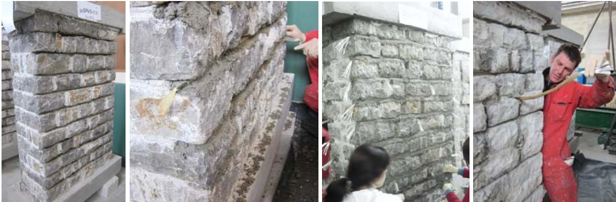
Slika 8.14: Zid, pripravljen za NSM (delno izpraznjene in očiščene spojnice), vstavljanje vrvic v spojnice, zapolnitev spojnic z malto in prečno povezovanje zidov (od leve proti desni)
