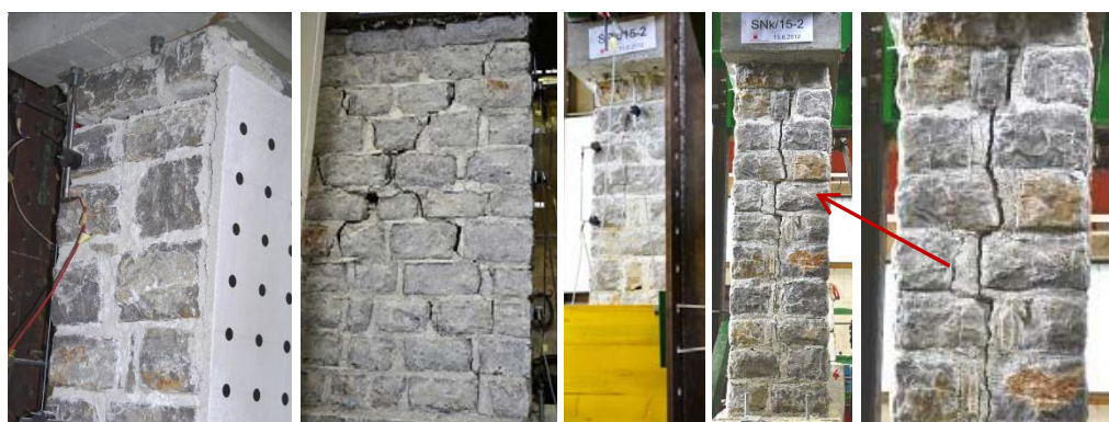
Slika 8.7: Upogibni mehanizem z odpiranjem maltne spojnice med prvima vrstama kamnitih blokov pri testu 2 - SNk-7.5-1, diagonalne strižne poškodbe zidu po testu 13 - SPk_15_2 ter razpoka med slojema po istem testu, razpoka med slojema zidu po testu 14 - SNk_15_2 (od leve proti desni)
