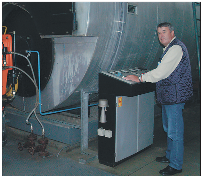
Vodja Energetike Janez Polanec med torkovim zagonom ene od plinskih peči v centralni kotlovnici v Ptuj.
