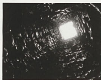
Katranske obloge v dimniku kot posledica zelo slabega zgorevanja zaradi vlažnih drv in nepravilnega kurjenja
