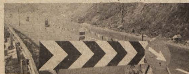
POŠKODOVANA CESTA – Na cesti Kočevje-Brod na Kolpi-Delnice je nova asfaltna cesta na več krajih poškodovana.
