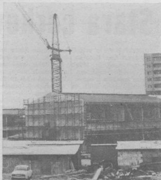
V krajevni skupnosti Dravljje delavci Megrada pospešeno gradijo osnovno šolo s 24 učilnicami, veliko in malo telovadnico ter vzgojnovarstveni zavod za 200 otrok. To sta 10. in 11. objekt II. samoprispevka ljubljanskih občanov v naši občini. (Foto: F. Rozman)
