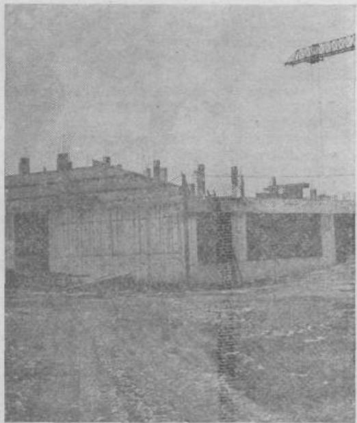
Delavci SGP Stavbenik Koper, tozđ Gradbeno operativa Ljubljana, gradijo v Medvodah na Svetju osnovno šolo s 14 učilnicami in večnamenskim prostorom. Objekt II. samoprispevka ljubljanskih občanov bodo predali namenu septembra prihodnje leto. (Foto: F. Rozman)
