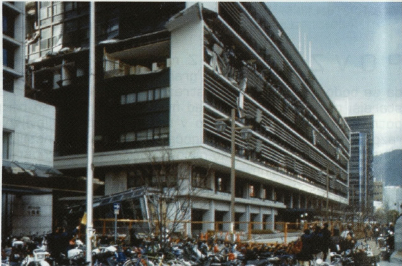
Slika 2: Kobe, 1995: porušitev moderne armiranobetonske stavbe, grajene po predpisih
