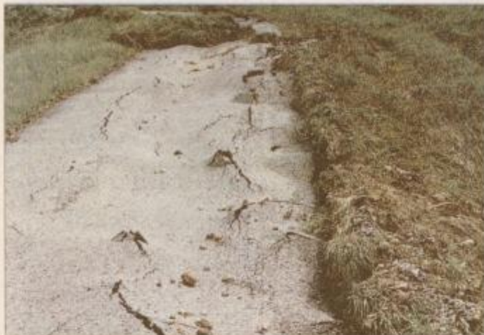
Tudi deli asfaltnih cest so povsem uničeni.
