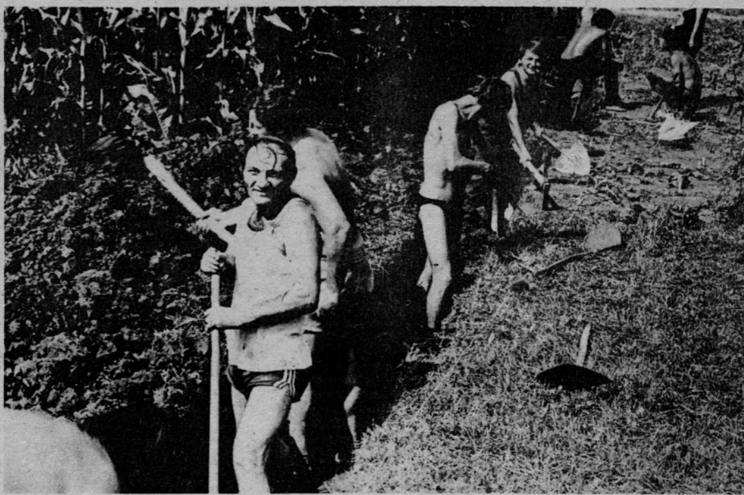
Delovna brigada podjetja za avtomatizacijo prometa iz Ljubljane pri izkopu jaska za telefonski kabel.
