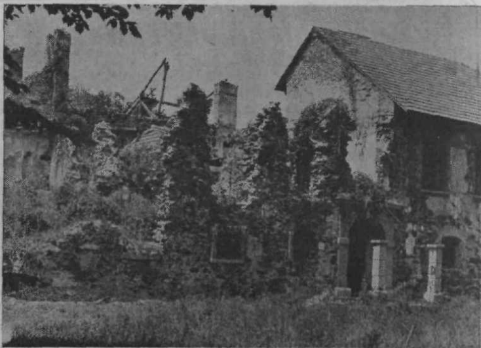
Takšno je bilo vzhodno pročelje graščine v Dolu julija meseca. Danes manjka še kakšna opeka več, kako dolgo pa bo škrbina sploh še zevala, pa je le še vprašanje časa.
