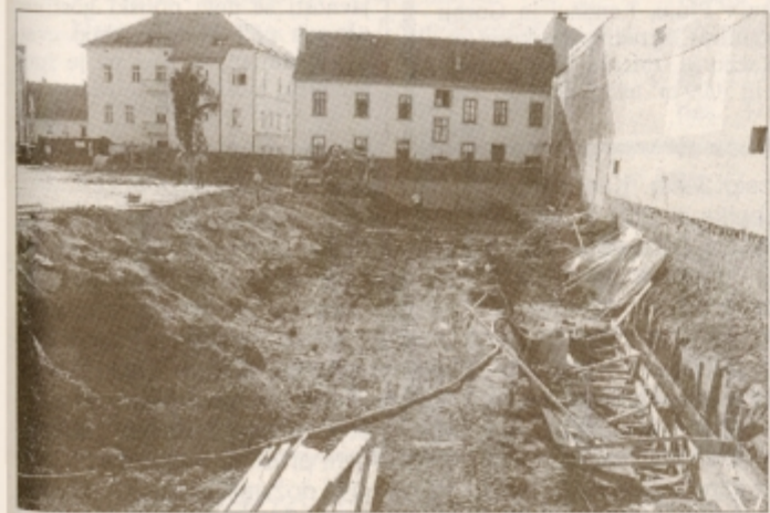
Na prostoru, kjer bo čez leto dni stal poštno-poslovni center, je te dni le še velika gradbena jama.
