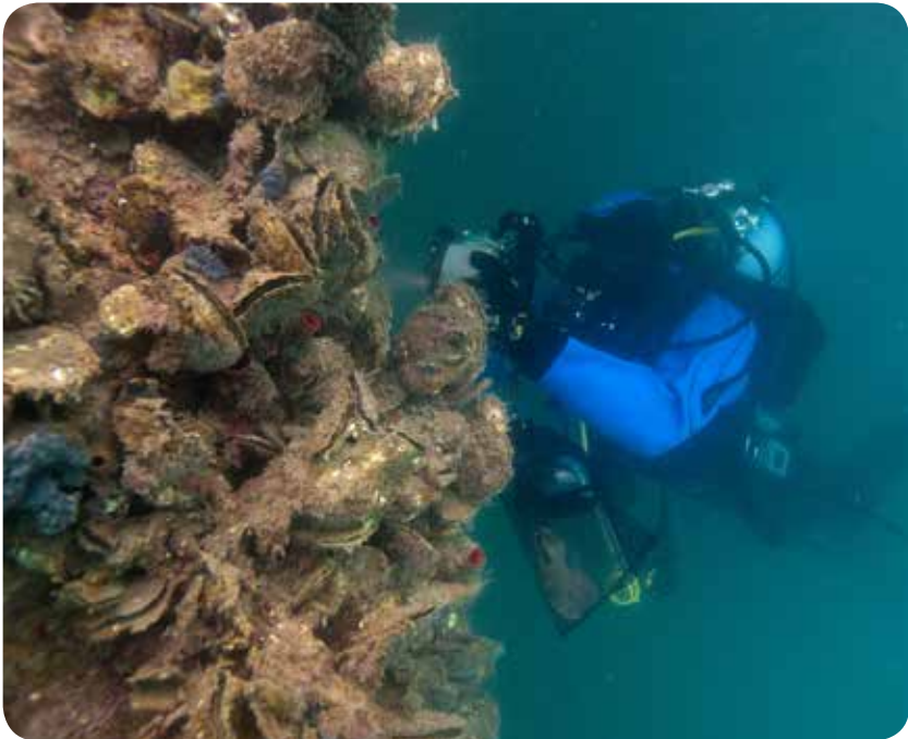
Slika 35: Obrast na stebrih v Luki Koper.
