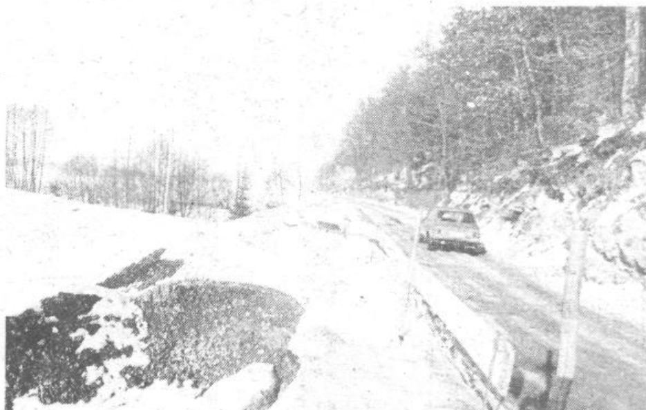
Lani so pričeli obnavljati cesto od Želimelj do Pijave gorice. Že letos pa se je vdrl del tega cestišča (na sliki). Je vzrok v slabi kvaliteti?
