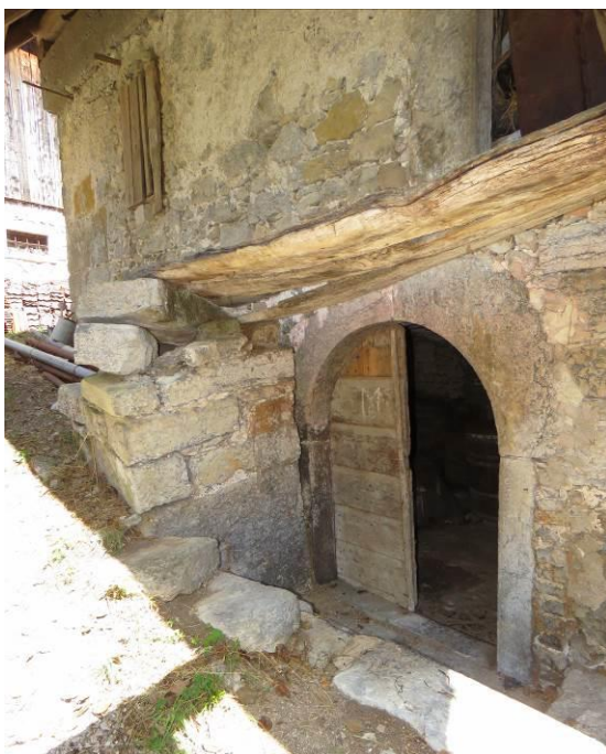
Slika 351: Levo stopnice in podrt gank, desno vhod v obokano klet stare hiše poleg Šimakove.
