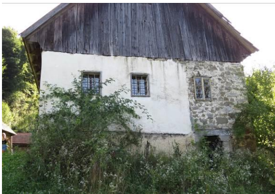
Slika 240: Fasada proti poti v dolino. Desno spodaj so vrata v klet s kamnitim portalom.
