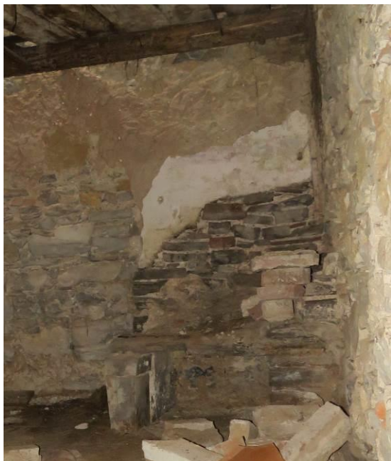
Slika 122: Ostanek druge krušne peči v kamri, ta ima še kamnito konstrukcijo kurišča in je bila kopaste oblike.
