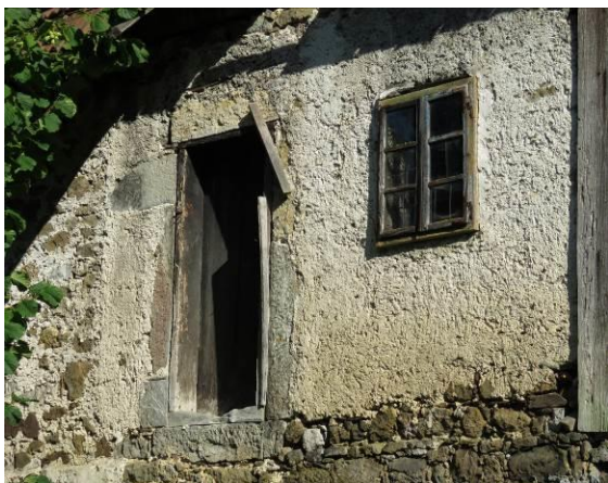
Slika 242: Še en detajl grajske gradnje, kamnit okvir vrat na gank. Le kakšna je zgodba te stavbe?
