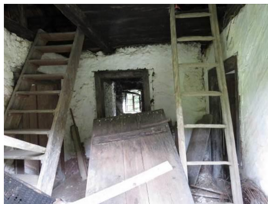
Slika 286: Kratka veža s stopnicami na odprto podstreho in kuhinjo v nadaljevanju. Desno vrata za hišo, levo za vežno kamro.
