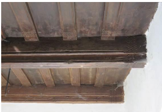
Slika 49: Leseni strop v dvorcu po izdelavi ne odstopa bistveno od stropov bogatejših kmetov. Večje so le dimenzije in stropne deske so bogateje profilirane.
