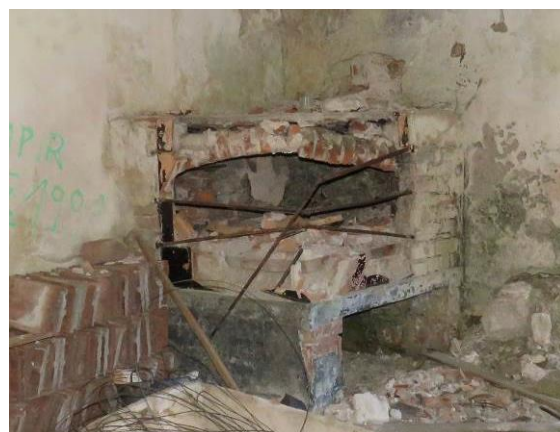
Slika 121: Natančno kvadratna hiša z ostankom krušne peči, vidna je konstrukcija plitvega oboka kurišča s stranskimi deli, a že brez pečnic.
