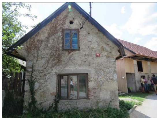
Slika 90: Češjenčeva bajta s cestne strani fasade, v pritličju sta bili nekoč dve majhni okni (sedaj zazidani). Zgornje okno je iz 1904. leta, spodnje vzdano po drugi vojni.
