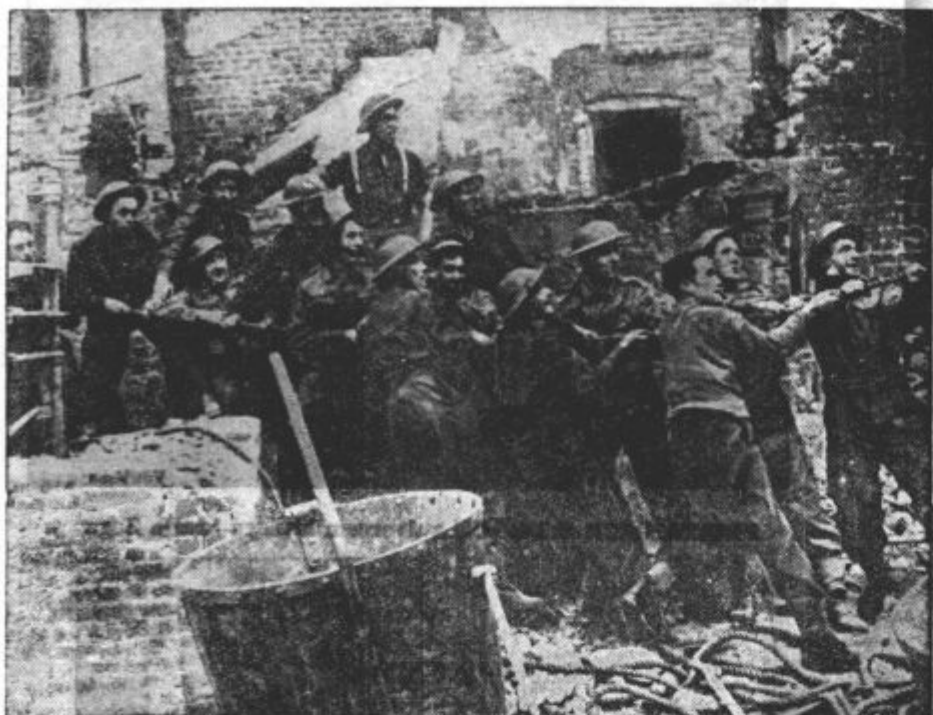
PODIRANJE POSKODOVANIH HIS V LONDONU. Posebni oddelki angleške vojske podirajo zgradbe, ki so jih razdejale sovražne bombe
