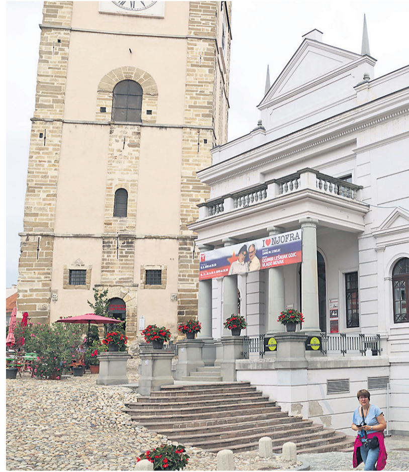
Omet s stropa odpada, sanitarije so nujno potrebne obnove, denarja za ureditev fasade
