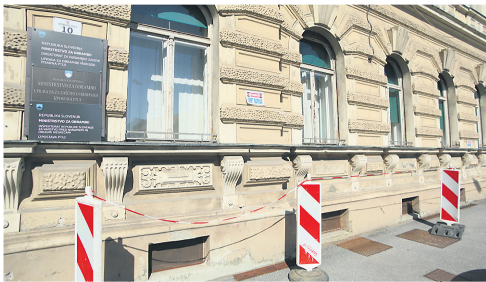
V državnem in občinskem proračunu denarja za obnovo nevarne fasade na objektu Upravne enote ni. Tabla z opozorilom o nevarnosti je na fasadi nameščena od 1. februarja letos.
