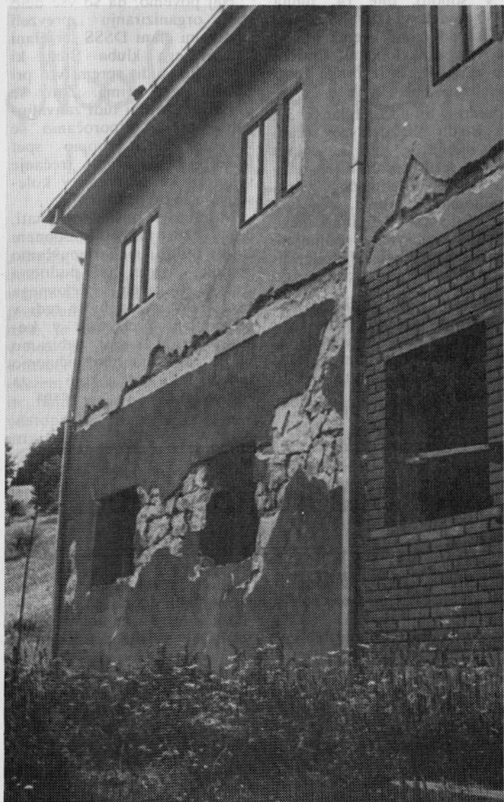
Nova hiša, potrebna sanacije
