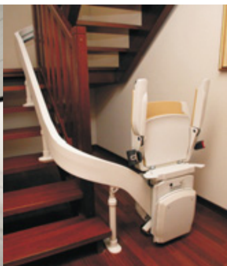
Stopniščni stol - vgraditev brez gradbenih dovoljenj
