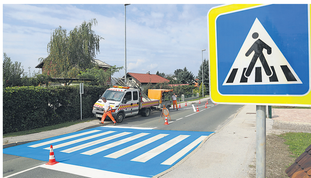
Delavci CPP so v Spuhlji na glavni cesti proti Markovcem dodatno označili nevarni prehod za pešce.
