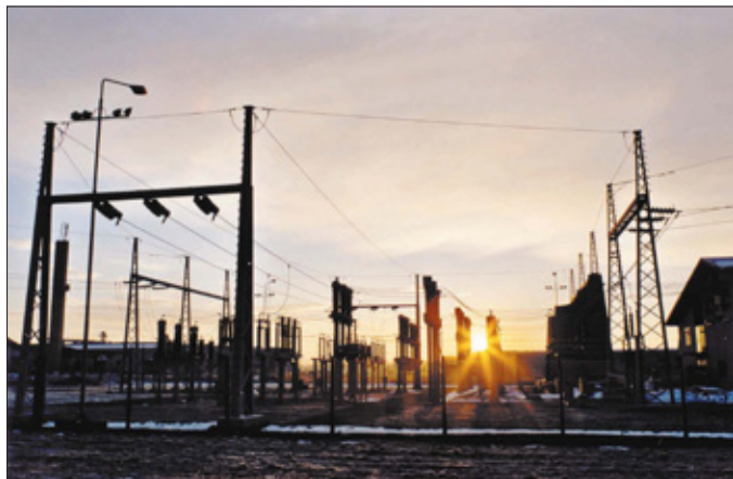
RTP Primskovo 110/20 kV je omogočila boljšo oskrbo z električno energijo v smeri proti Letališču Brnik, Krvavcu in stanovanjskemu kompleksu Planina. (Foto: D. Papler)
