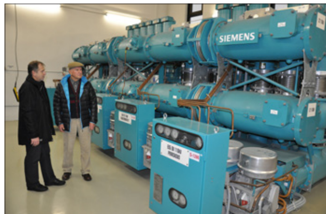
Ob obisku 19. novembra 2016 se je nekdanji direktor Elektra Gorenjska in častni občan Mestne občine Kranj, mag. Drago Štefe (na posnetku desno), zanimal za delovanje razdelilne transformatorske postaje Zlato polje v Kranju. RTP Zlato polje je bila v distribuciji Slovenije prva razdelilna transformatorska postaja s 110 kV GIS stikališčem, zgrajena v letih 1999–2000. Karlo Zupanc (na posnetku levo), vodja vzdrževanja v organizacijski enoti Distribucijsko omrežje Elektra Gorenjska, je takrat poudaril, da je RTP Zlato polje obratovalno brezhibna vseh 16 let z minimalnimi stroški. (Foto: D. Papler)
