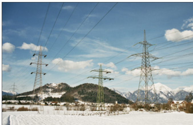
Prenosni in distribucijski daljnovodi najvišjih 110 kV in 400 kV napetosti v Stražišču pri Kranju. (Foto: D. Papler)
